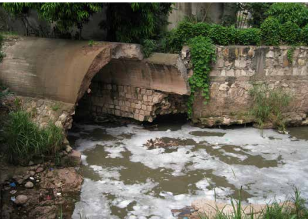
Daños en estructuras en la Quebrada la Orejona (der) y obra de encauzamiento en la Quebrada Seca (izq). En el drenaje pluvial se presentan algunos problemas que hacen que el funcionamiento esperado falle, debido a la reducción o estrangulamientos de los mismos por construcción de embaúles mal diseñados y contruidos, relleno de los cauces para ampliar áreas para la construcción de viviendas, descargas de todo tipo de sólidos o basuras que cambian su régimen de velocidades, que en algunos casos generan o contribuyen al desbordamiento de las quebradas. Además esta situación de mal funcionamiento de los cauces durante grandes crecidas, genera en zonas bajas de la ciudad estancamiento de las descargas de los afluentes y por consiguiente se produce inundaciones aguas arriba de la confluencia.
